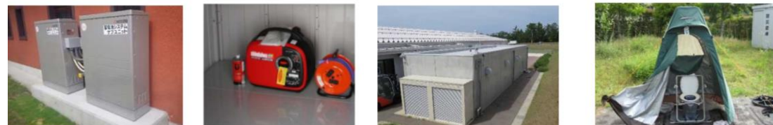
無停電設備（蓄電池・移動用発電機）防災倉庫
