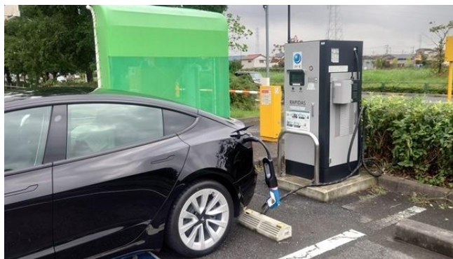
急速充電器の設置事例（舎人公園駐車場）
