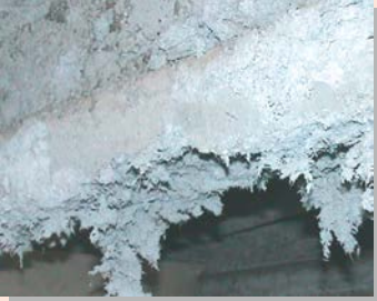
例) 吹付けアスベスト(青石綿)
