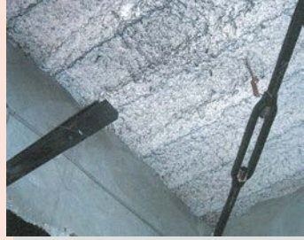
例) 石綿含有吹付けロックウール
