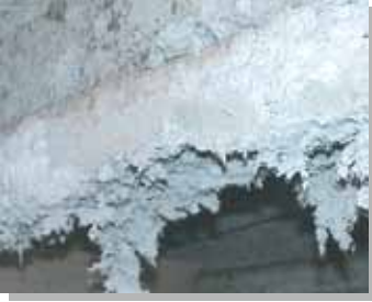
例) 吹付けアスベスト(青石綿)
