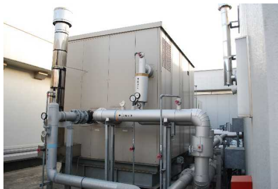
コジェネレーションシステム排熱利用冷凍機
