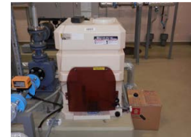
写真④ 塩素注入装置
