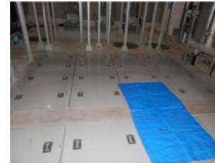
写真④ 膜分離槽
