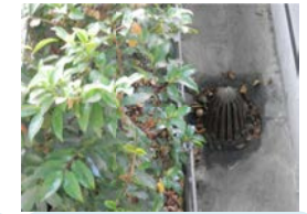
写真③ テラスの ルーフトレンドレン 屋上だけでなく、テラス等ビルの各所から、雨水の集水を行っている。
