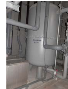
写真⑤ 活性炭処理槽
