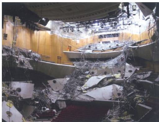
東日本大震災時での天井落下による被害 (音楽ホール)
