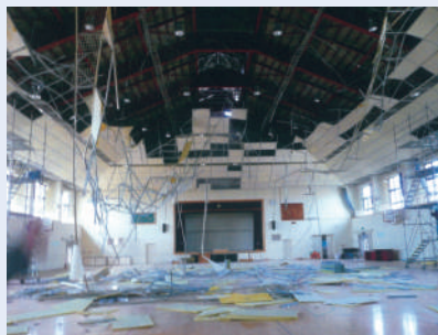
体育館における天井の脱落
