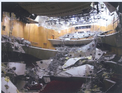
音楽ホールにおける天井の脱落
