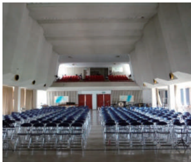
改修前の凸凹天井
