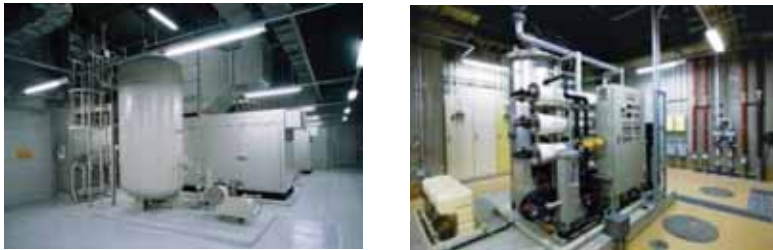
コージェネレーションシステム
