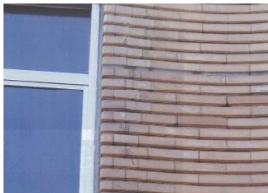
修復箇所のクラック（届出資料より）
