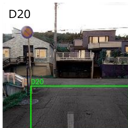
D20 亀甲状ひび割れ
