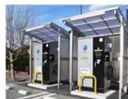
充電施設 蓄電池
